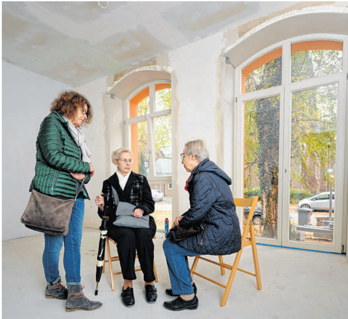
Karin Rienets von der Genossenschaft Glockenhof (r.) spricht mit Margret Lahme (M.) und deren Tochter Anja Langer im Rohbau des ehemaligen Schulgebäudes. Die Seniorin erwägt den Einzug in die geplante Pflege-WG. FOTO: OLAF ZIEGLER
